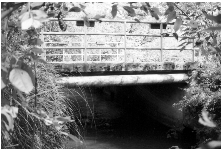
Figura 6: Attraversamento del canale del Molino o Cantarana. La luce di deflusso dell'attraversamento in calcestruzzo armato è di 1.5-2 metri circa. Fondovalle, a nord-ovest di Vaie in prossimità del confine comunale con S. Antonino di Susa, punto quotato 377.6m (scheda censimento n. 5, allegato n. II).
